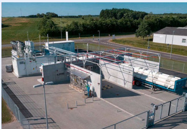
Blick auf die HYbalance-Anlage (Bild: Hydrogenvalley)
